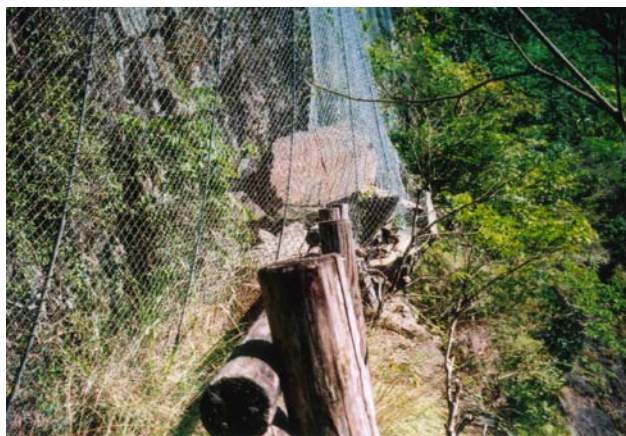
大吊橋下の落石
