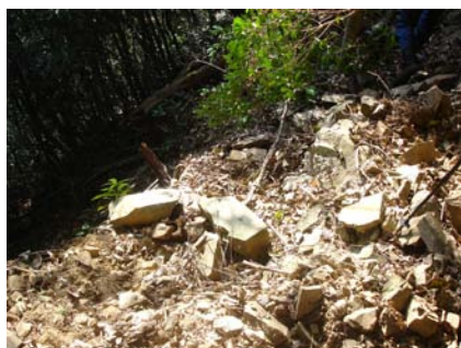
自然歩道崩落の様子
